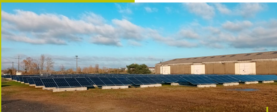
Parc PV solaire sur l'ancienne déchèterie de Messemé
