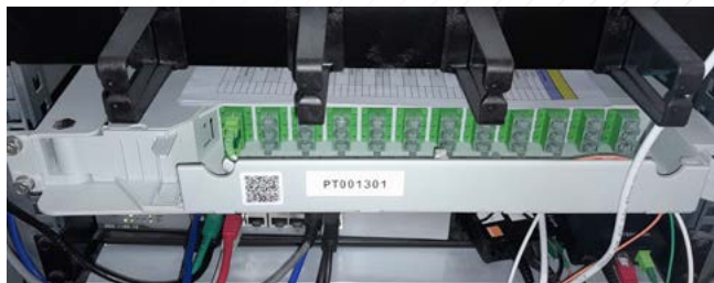
Point de branchement optique interne de la Maison de Santé de Loudun mis en service en novembre 2022
